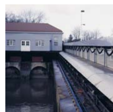
Tore auf! Leitungswagen-System Programm 0330 auf einer Schleusenanlage
